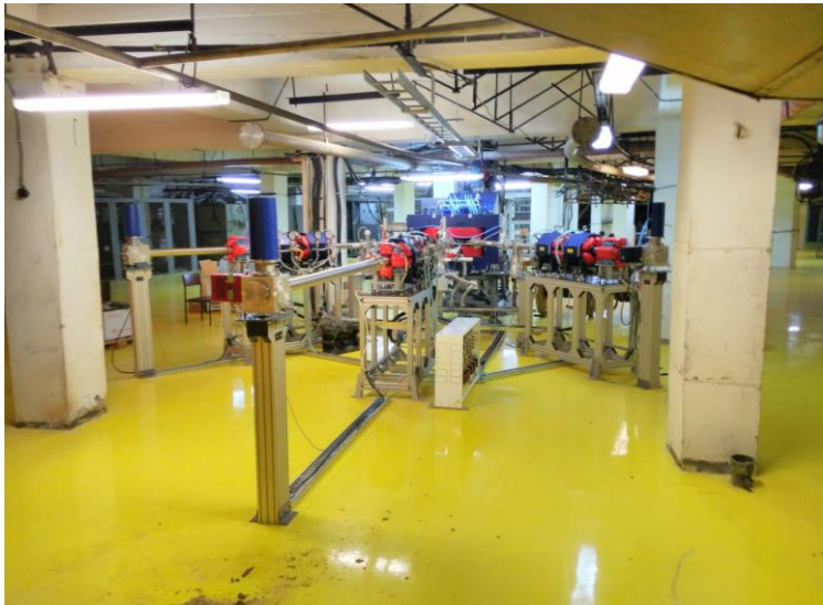
Рис 14. Разводка пучков к мишенным станциям радиоизотопного комплекса РИЦ-80, подвал экспериментального зала синхроциклотрона Ц-1000
